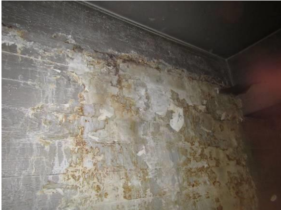
Kuva 14 Kosteusvaurioita maanvastaisessa seinässä.
