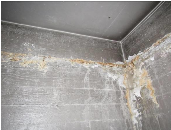
Kuva 16 Kosteusvaurioita maanvastaisessa seinässä.
