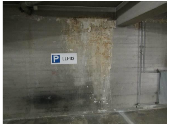
Kuva 17 Kosteusvaurioita maanvastaisessa seinässä.
