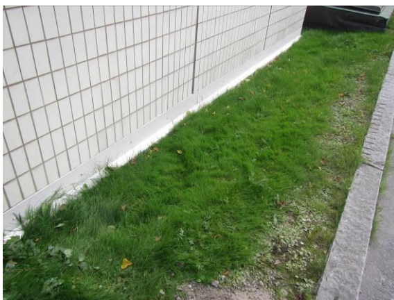
Kuva 11 Pihakannen päällä oleva nurmialue sitoo kosteutta, eikä kosteus pääse poistumaan rakenteesta, mikä aiheuttaa osaltaan vuotoja.
