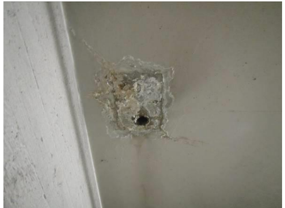
Kuva 9 Vedenpoistoputki, jonka alapuolella ei ole vedenohjausta.
