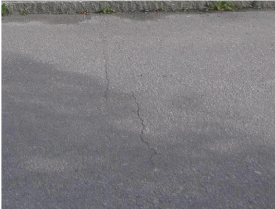
Kuva 13 Halkeamia asfaltin yläpinnassa.
