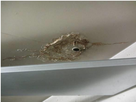
Kuva 8 Laatan alapintaan tehty vedenpoistoputki, ympärillä kosteusjälkiä.
