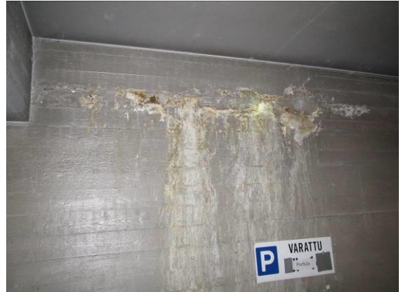
Kuva 15 Kosteusvaurioita maanvastaisessa seinässä.
