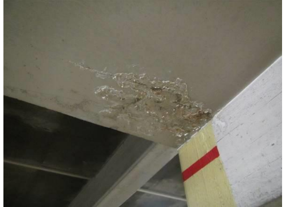
Kuva 7 Laatan alapinnan reuna-alueen kosteusjälkiä.
