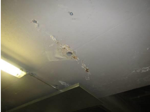
Kuva 6 Kosteusjälkiä ja näytteenottokohta VT 2.
